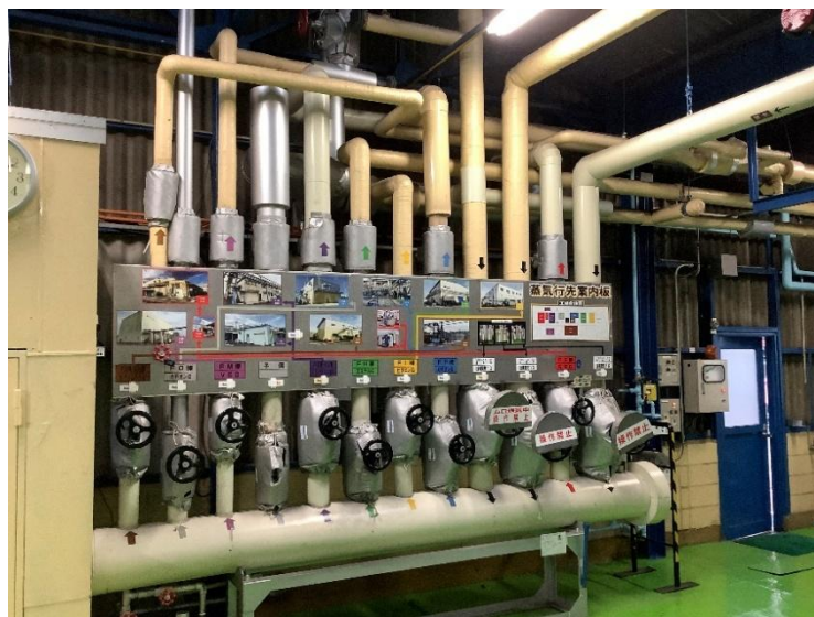
ボイラー室ヘッダー
