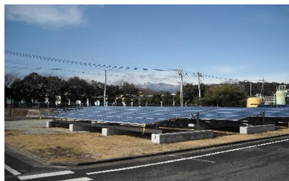
太陽光発電システム 那須事業所
